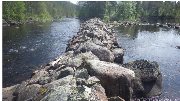
Avskärmande rensvall i Voxnan/N om Björnbokojan: Denna konstruktion som är en fortsättning av den i bilden ovan bör rivas helt.
