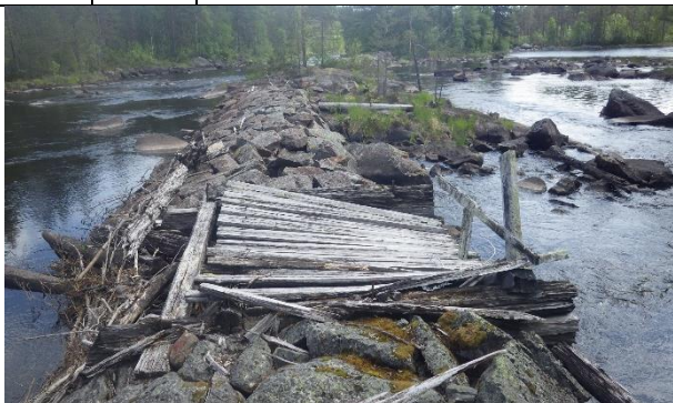
Del av ledaren vilken bör öppnas partiellt.
