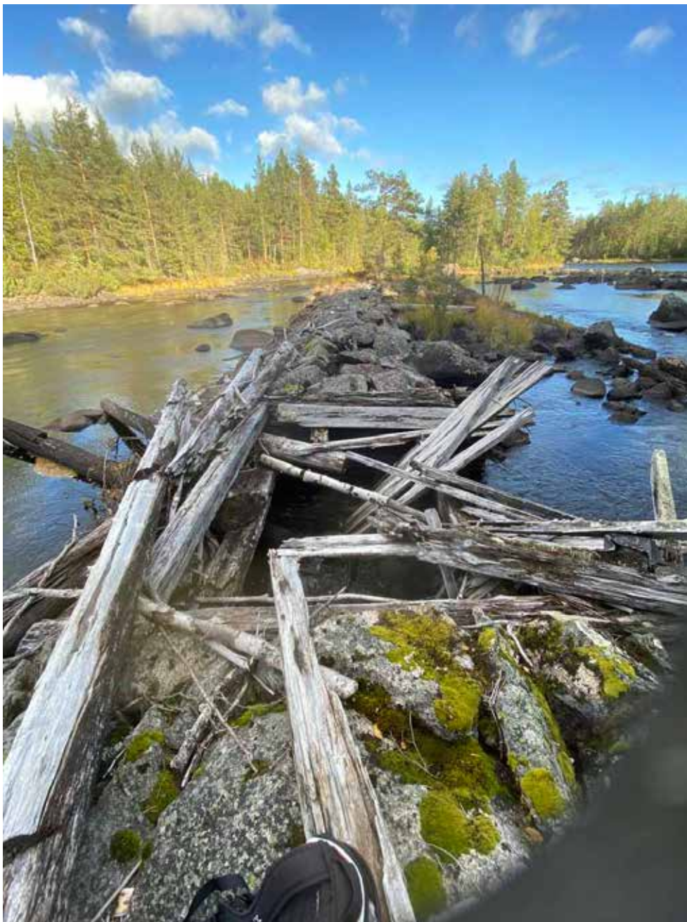
Lämning 7_3, L2020:9422. Stenkista, med synlig träkonstruktion och rest efter dammlucka. Lämningen är ca 40 m l (Ö-V), 4–5 m br och 1,5–2 m h. Vid fältbesöket var 1 stockvarv synligt. Dammluckan, kvadratisk öppning, med timrad träkonstruktion, ca 4x4 m, delvis raserad. Kulturvärde: Röd
